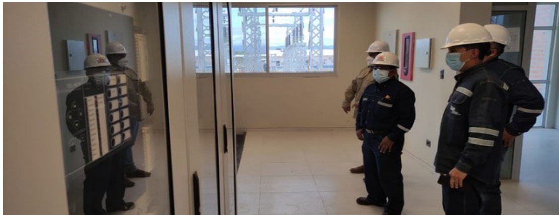
Inspección a la Sala de Control, Subestación Bermejo
