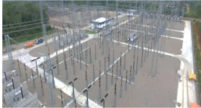
Subestación Santivañez 500 kV
